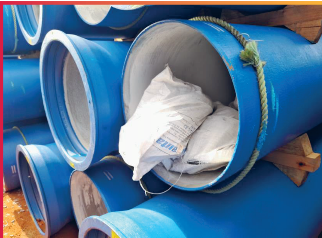
↘ Armazenamento incorreto de anéis de borracha
