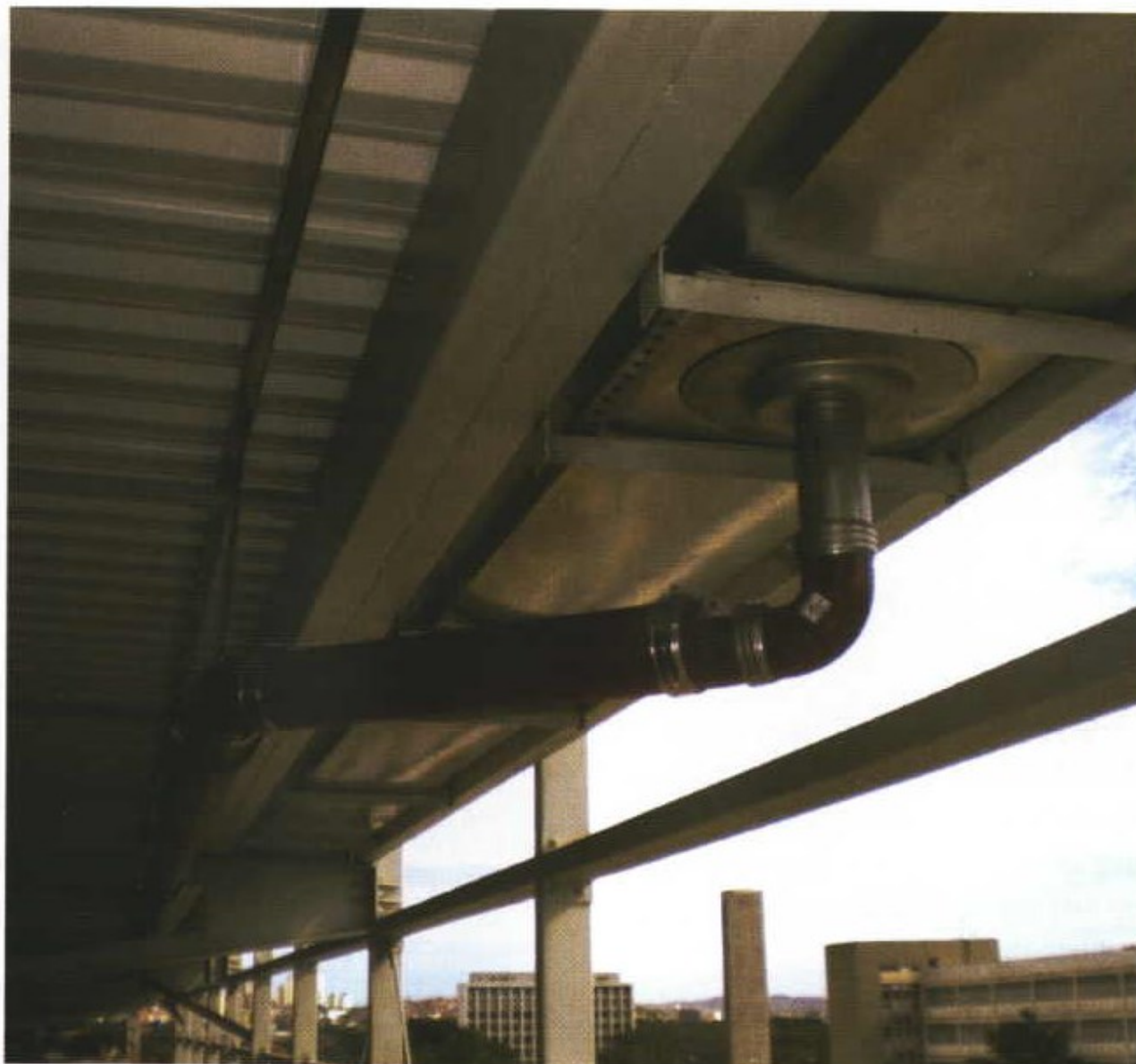
Figura 8 – Captador instalado em calha metálica (visão inferior)
